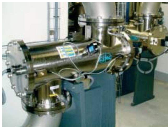
Déchloramineur Cifec DC Piscine de Neuilly S/Seine (92)
